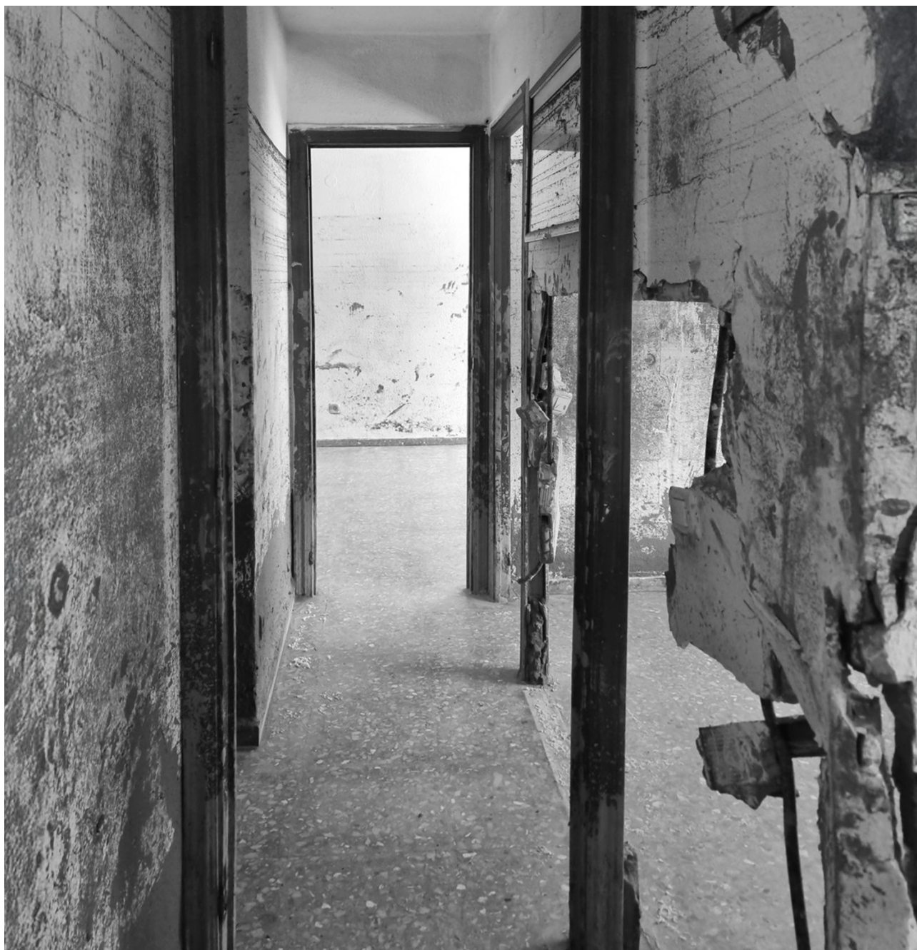
Daños producidos en el grupo Finca Roja del Torrent, Valencia
