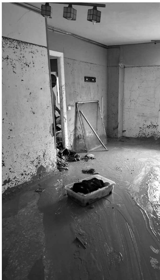
Daños en el edificio de La Torre, Valencia
